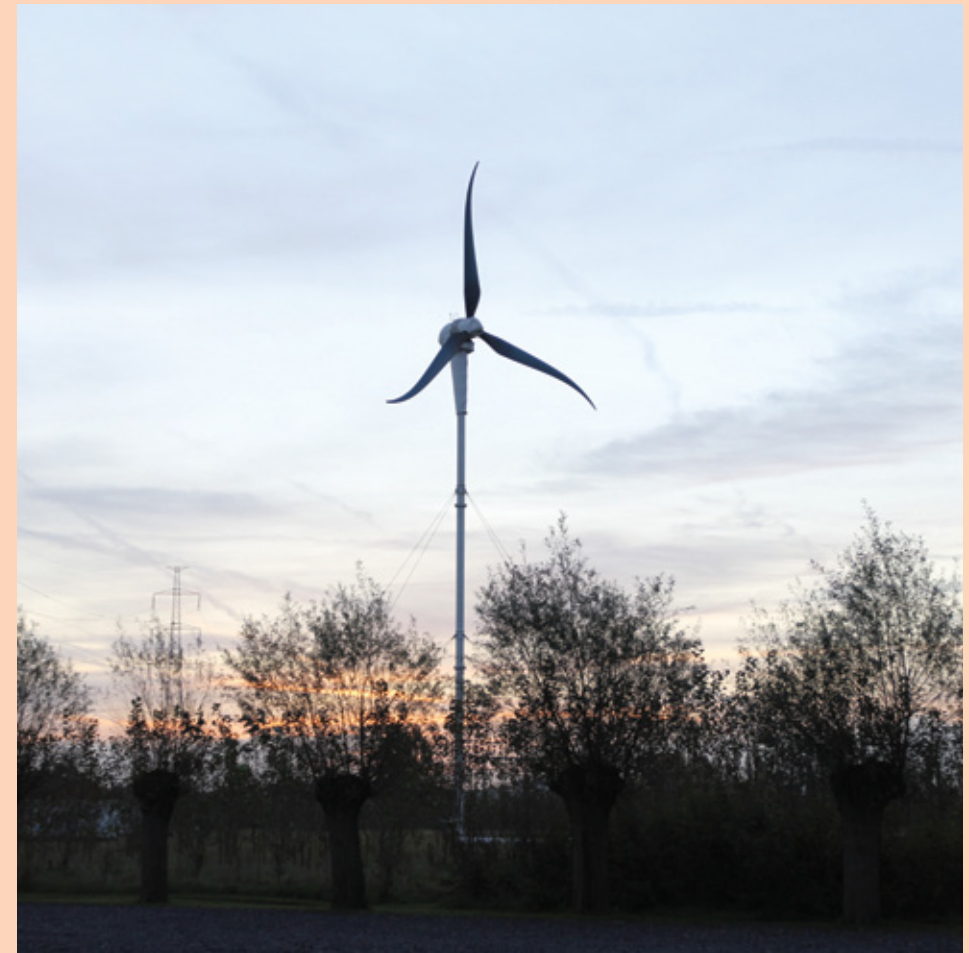
De XANT M windturbine is een middelgrote molen van 100 kilowatt.
